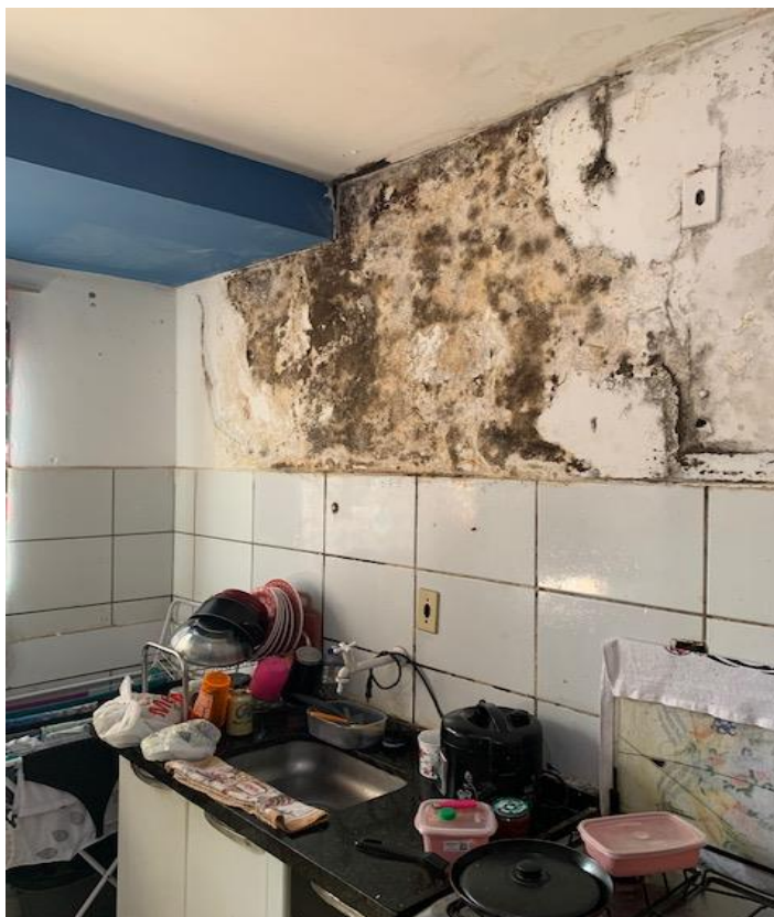
Foto 9 – Problema do mesmo vazamento (no shaft) que ocorre no banheiro visto pela parede da cozinha
