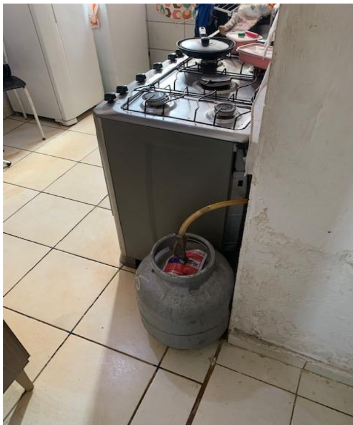
Foto11 – Detalhe do posicionamento de um botijão de gás pois o sistema externo, segundo os moradores esta inoperante talvez por entupimento no encanamento.
