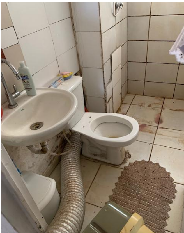
Foto 8 - Mais um detalhe da situação do revestimento cerâmico do banheiro Tanto no piso quanto nas paredes
