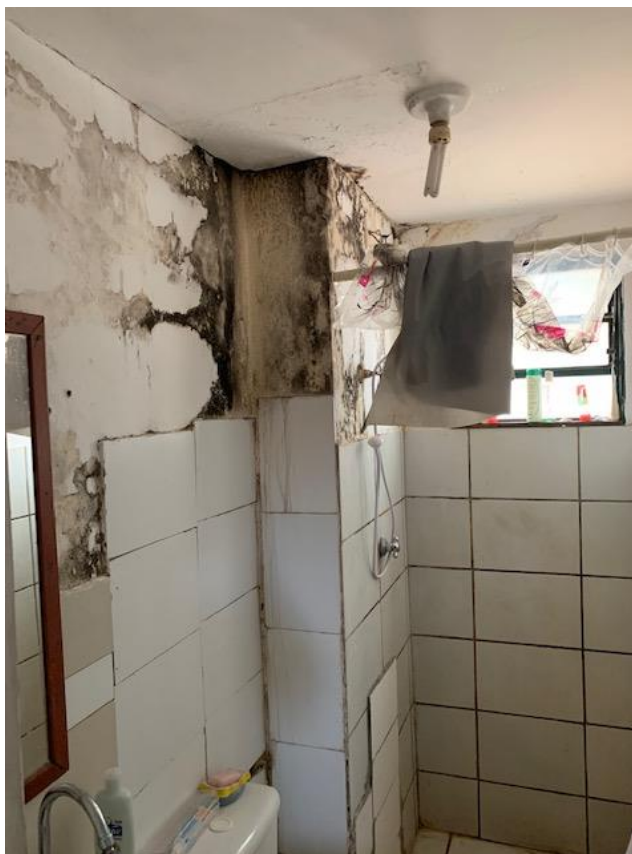
Foto 7 – Detalhe do vazamento existente no banheiro, vindo dos imóveis de cima pelo shaft afetando bastante o local onde esta instalado o registro de controle do chuveiro.
